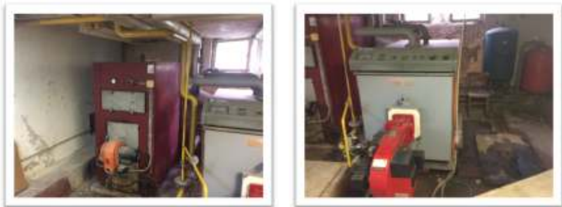
Slika 1 Prikaz kotlova toplovodne kotlovnice
